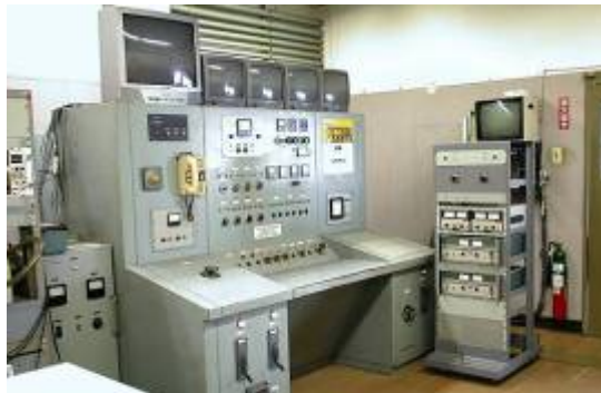
運転室・制御卓
