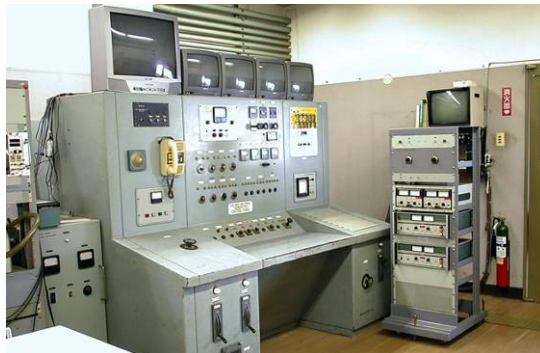
運転室・制御卓
