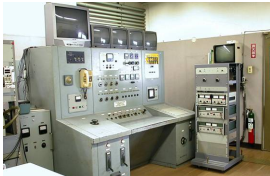
運転室・制御卓
